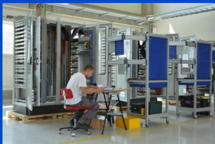
ALSTOM Riyadh Metro 330 kV GIS LVCC
